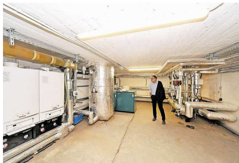
Klaus Schavan, technischer Geschäftsführer des Gebäudemanagements, schaut sich im Keller der Schule um. Auch die Heizungsanlage musste komplett erneuert werden.
