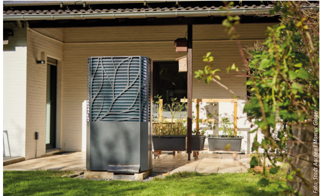
Eine klimafreundliche Alternative: Die Wärmepumpe.
