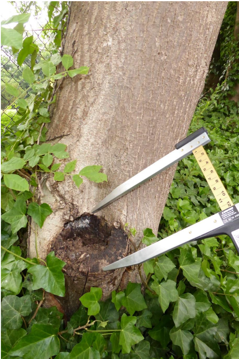
Abbildung 5: Baum Nr. 32, Faulstelle an Stammbasis
