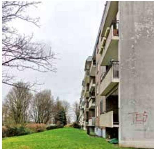
Dichtes Wohnen im grünen Umfeld: Der Driescher Hof in Forst liegt im Fokus des integrierten Planungsprozesses.
