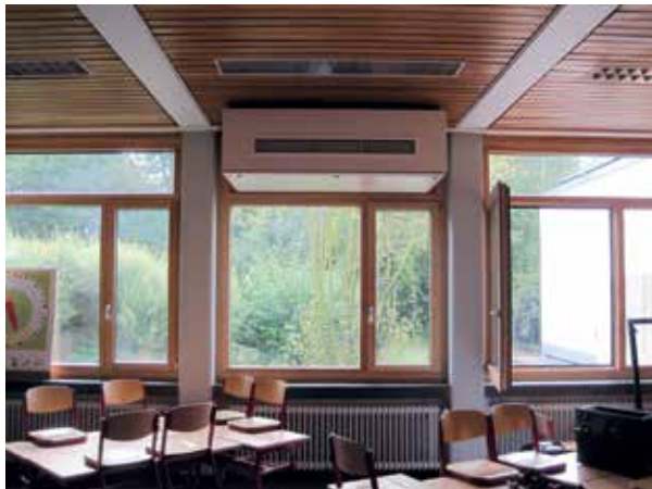
GS Karl-Kuck, dezentrales Lüftungsgerät, Architekt: Linie 4, Aachen
