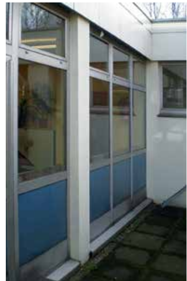
Nicht funktioneller Innenhof vor Sanierung
