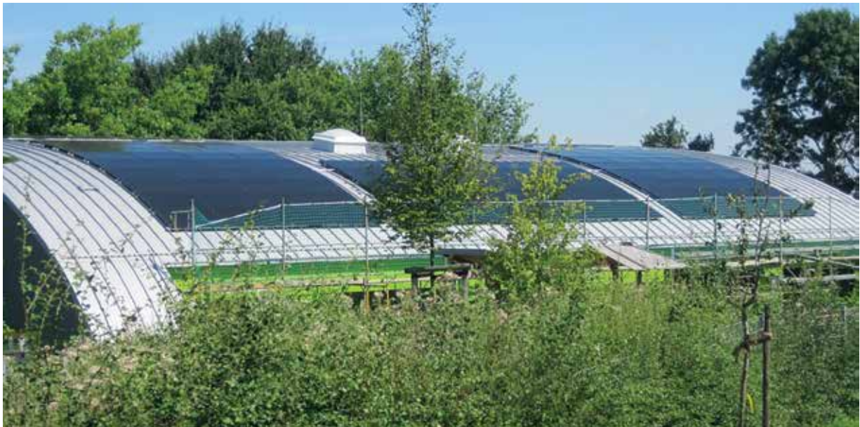
KiTa Sandhäuschen, Photovoltaikanlage
