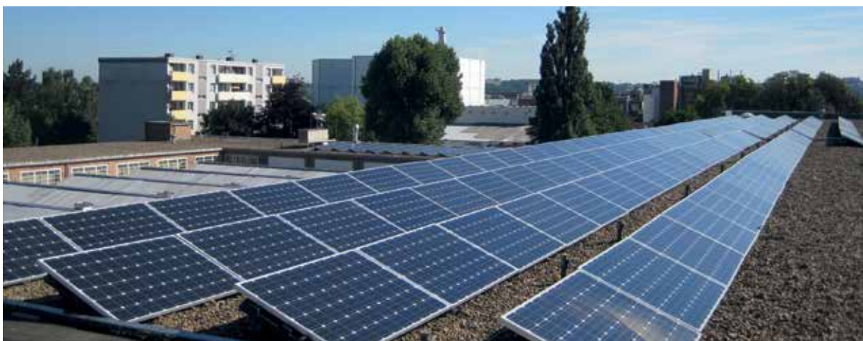
Photovoltaikanlage Ludwig Forum
