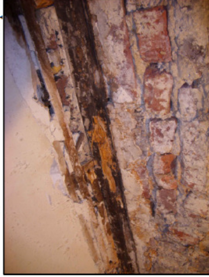
Vorzustand: zerstörte Schwelle
