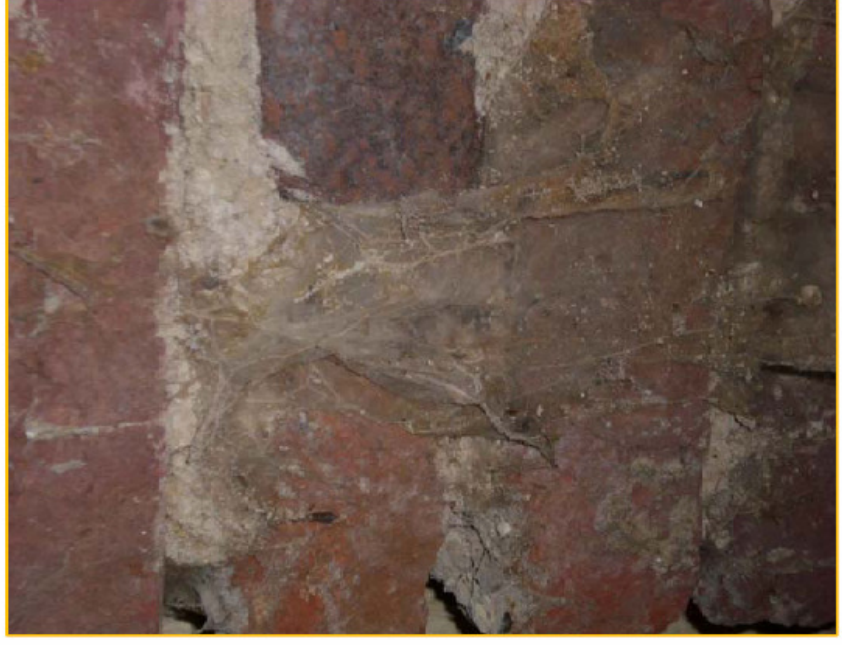
Strang- und Luftmyzel am Mauerwerk Kutscherhaus
