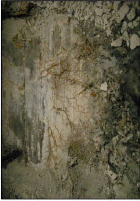
Strangmyzete des wilden Hausschwammes in der Geschossdecke
