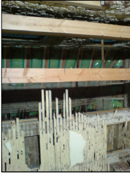
erhaltener Rest der Spalierlattung
