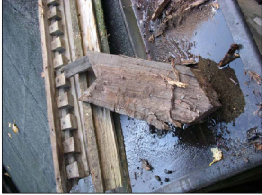
Schadensdokumentation in Zuge der Demontage
