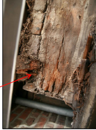
Vorzustand: Träger zerstört
