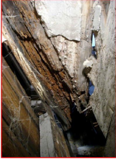
Brannfäule und Wurfelbruch als Folge des echten Hausschwammes
