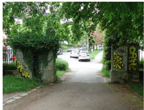
Abb.98 Mauerschäden am Eingang Pippinstraße
