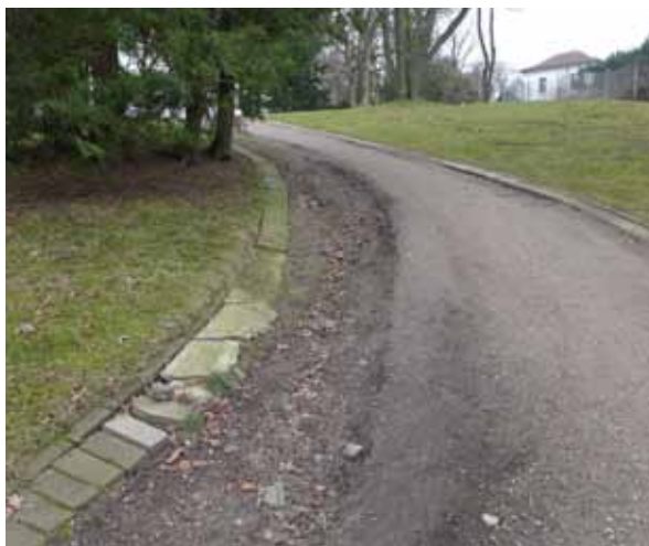
Abb.86 Erosionen durch starkes Gefälle
