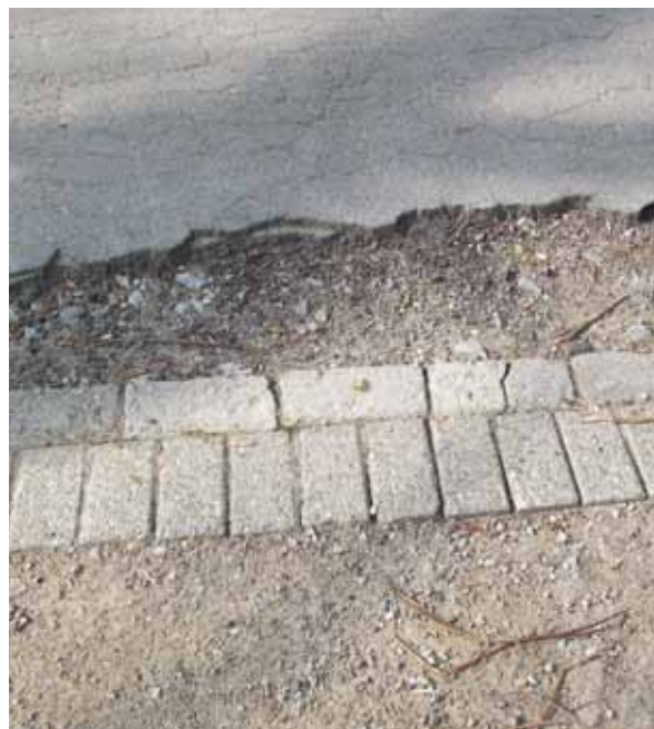
Abb.120 Unterschiedliche defekte Beläge im Stadtpark
