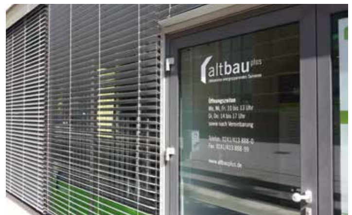
Außen angebrachter Sonnenschutz ist der wirkungsvollste.
