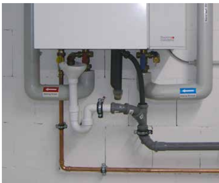
Kondensatablauf: Größere Mengen Kondenswasser sind ein Zeichen dafür, dass der Brennwert gut ausgenutzt wird.
