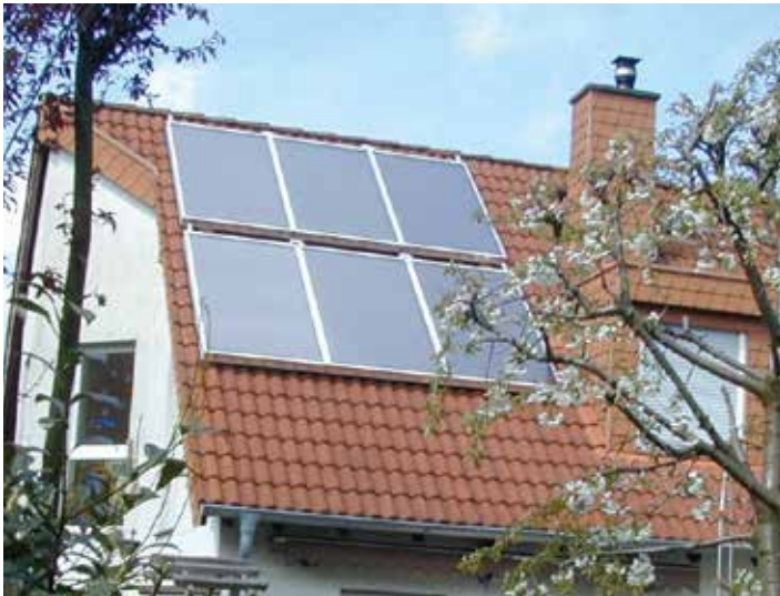
Solarkollektoren (Flachkollektoren) zur Erwärmung von Wasser
